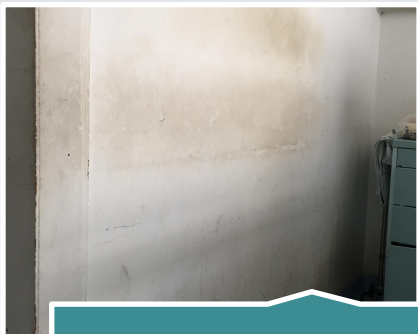
涂料 脏污腐蚀
