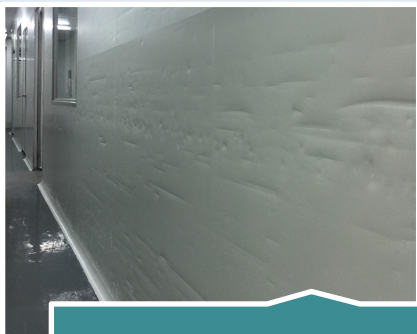
墙板 碰撞擦伤
